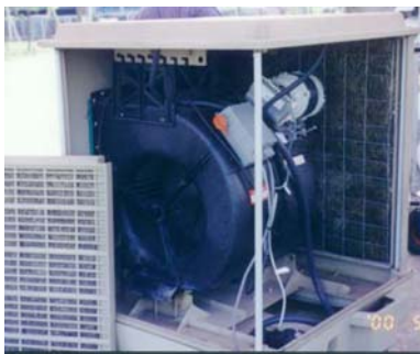
圖 13a. 側吹式正壓式蒸發冷卻單元機
