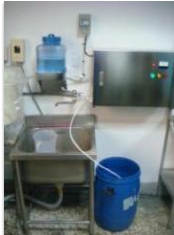
Biotech Corp. 生技廠- 廠區設備環境
